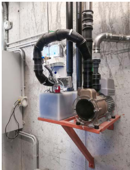
Locale tecnico con pompa e cassetta Jets™
